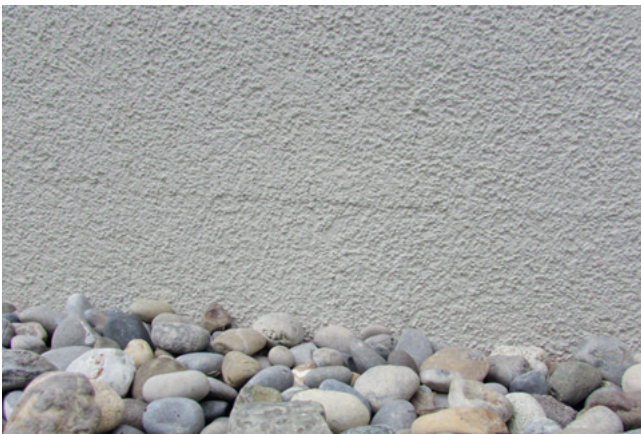
Abb. 2 Abzeichnung der Sockeldämmplatte beim Materialübergang.
